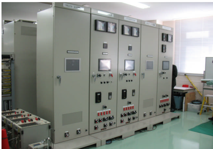
一体型制御装置全景
